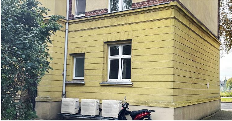
Außeneinheiten der Splitgeräte
