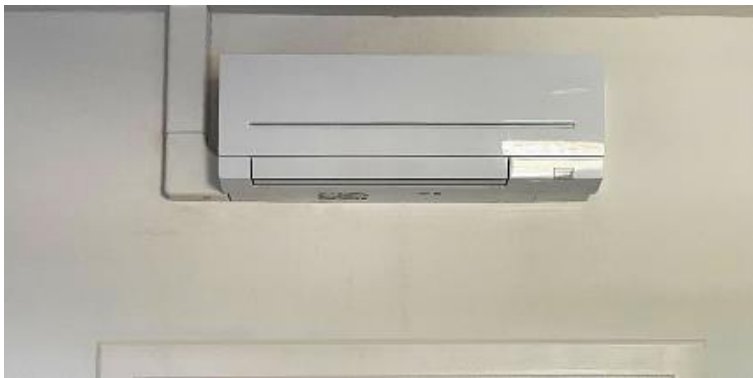
Inneneinheiten der Splitgeräte
