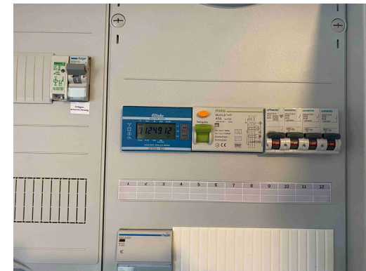
Zusätzliche Messtechnik zur Verbrauchsabrechnung
